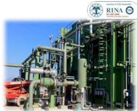
Centrale stoccaggio Gas EDISON
