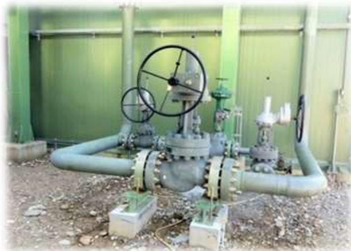
Centrale stoccaggio Gas EDISON
