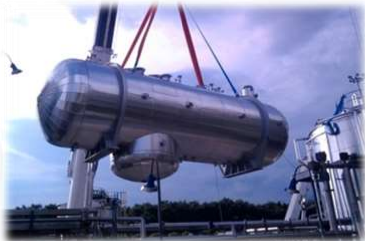
Seratoio Degasing Eni Spa COVA
