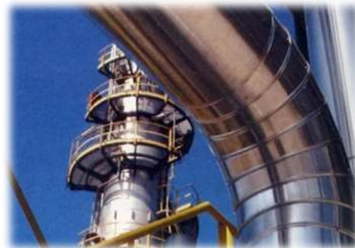
Caldaia San Severo (FG)
