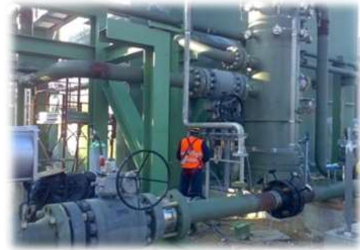
Centrale stoccaggio Gas EDISON
