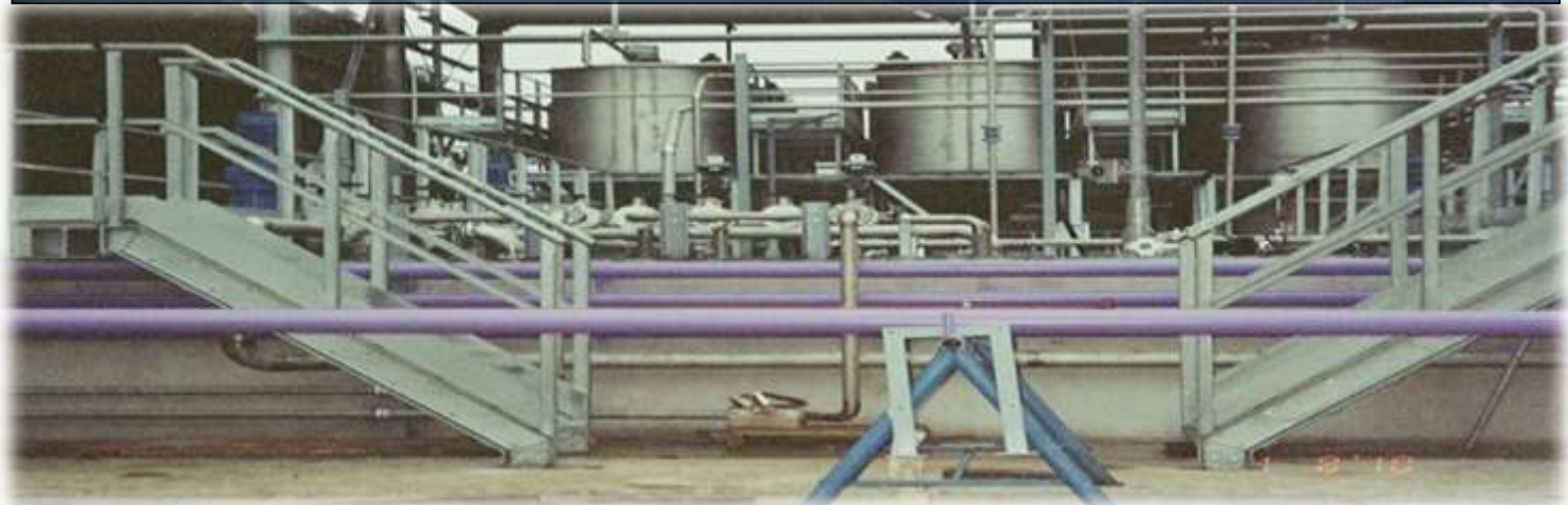
Impianto Trattamento Fanghi: ILVA
