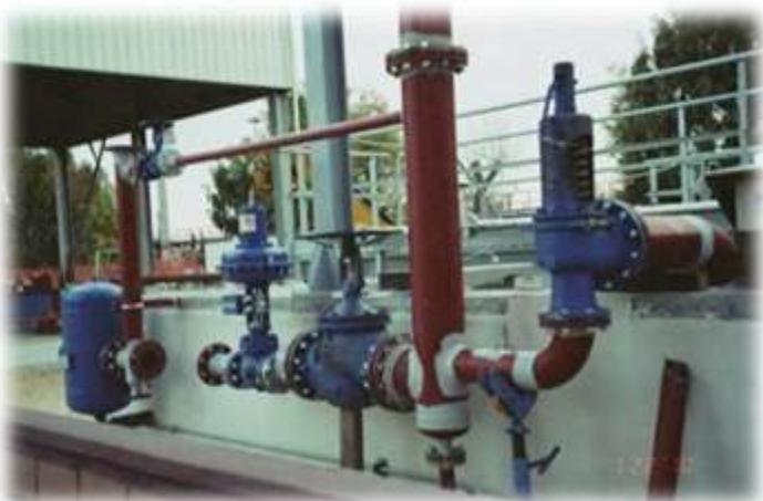
Impianto Trattamento Fanghi: ILVA
