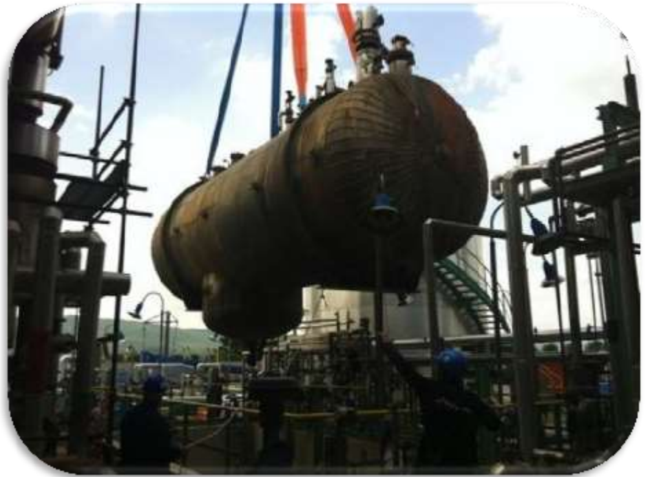
Serbatoio Degasing Eni S.p.A. Centro Olio Val'D'agri
