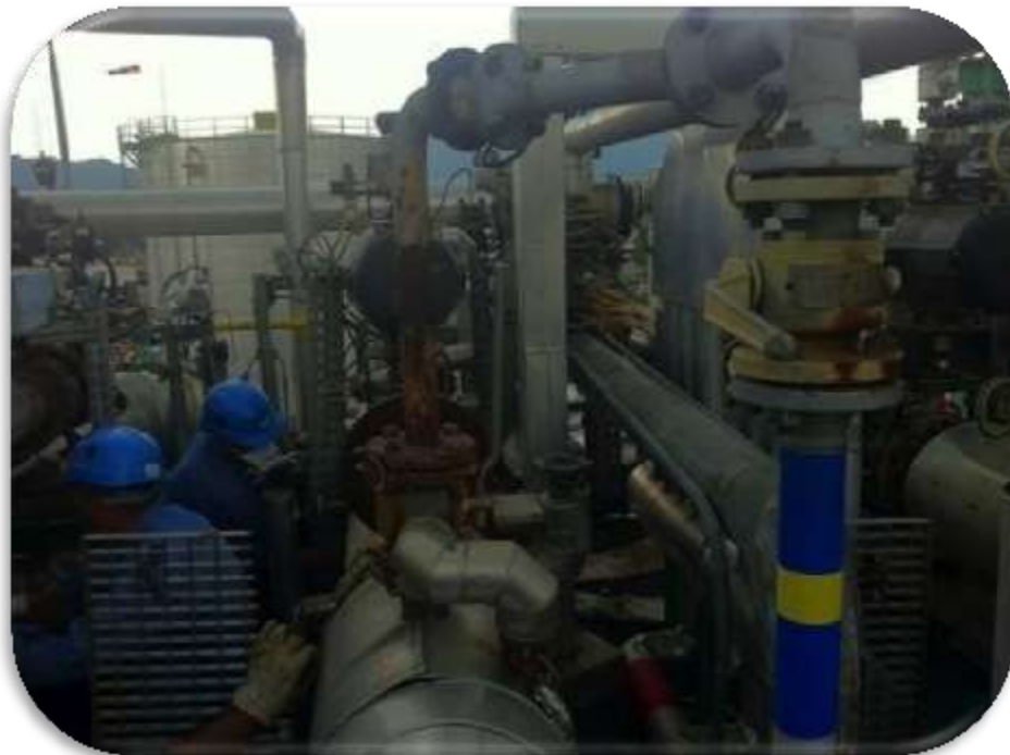
Tie-Ins 13 Eni S.p.A. Centro Olio Val D'Agri
