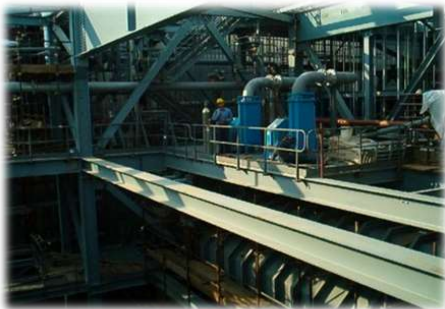
FIAT Melfi Pensotti Caldaie
