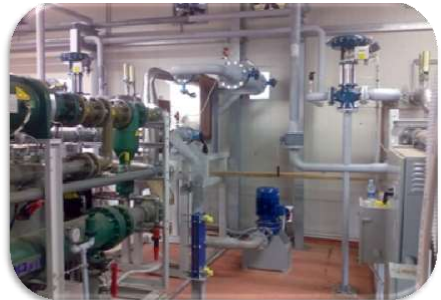
Impianto Biomasse Puglia
