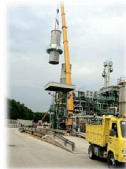
Termodistruttore Eni S.p.A. Centro Olio Val D'Agri
